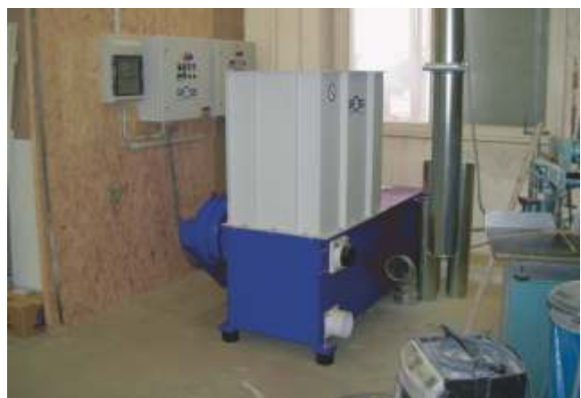
GAZ 62 Installation an eine Absaugung
